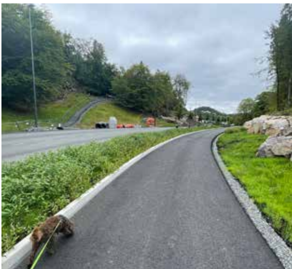
Håkonshellavegen blir opprustet, og ventes å stå ferdig våren 2024. Foto: Vestland fylkeskommune
